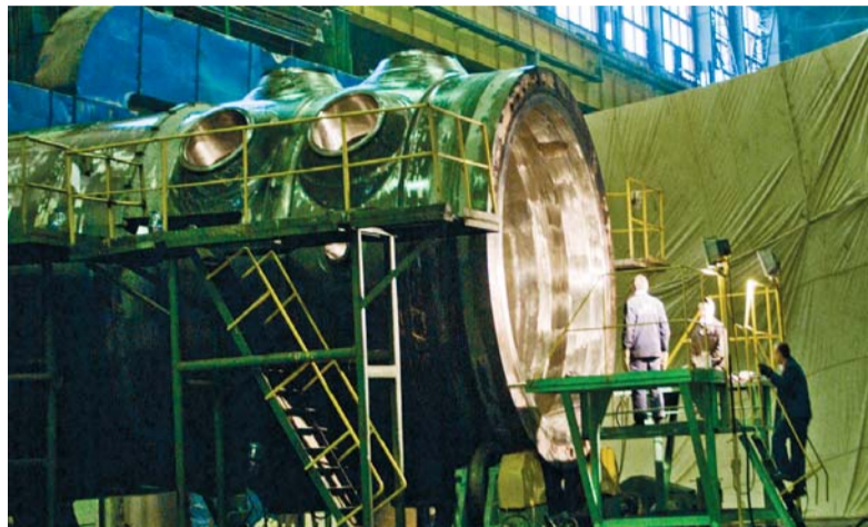
Сварочные работы выполнены в полном соответствии с требованиями правил изготовления оборудования для АЭС
